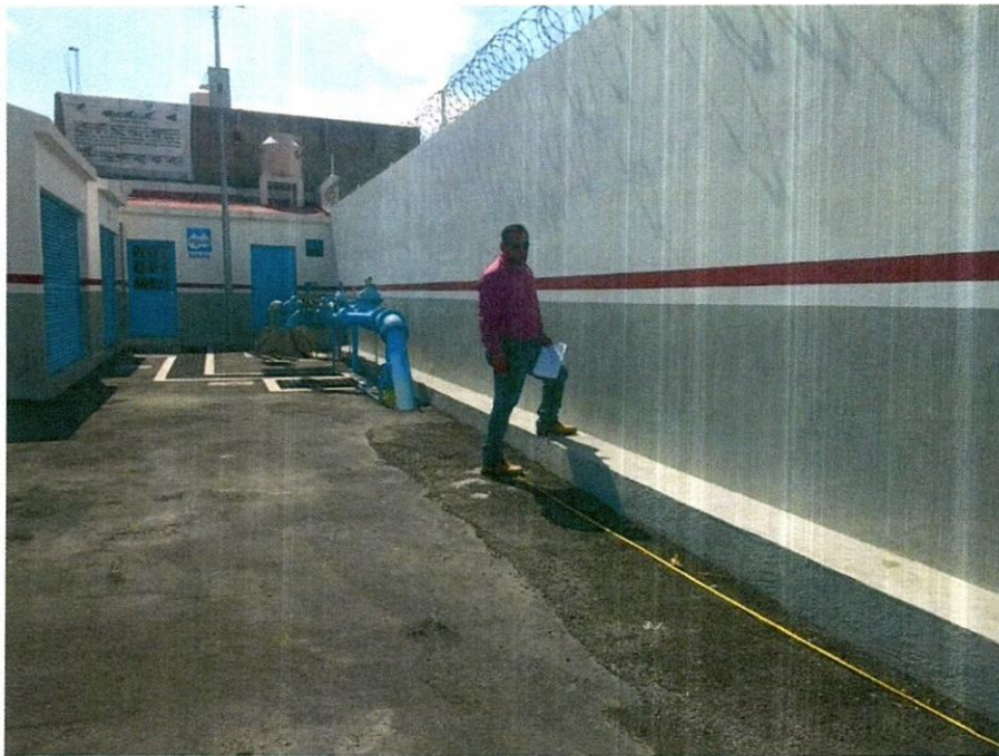
LÍNEA DE 12", SALIDA DEL TREN DE DESCARGA
