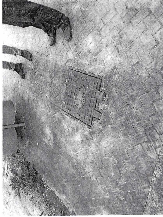
Tapa de caja de operación de válvula
