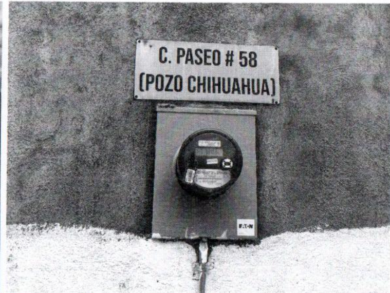
MEDIDOR DE CFE PARA CONSUMO ELECTRICO DEL POZO CHIHUAHUA
