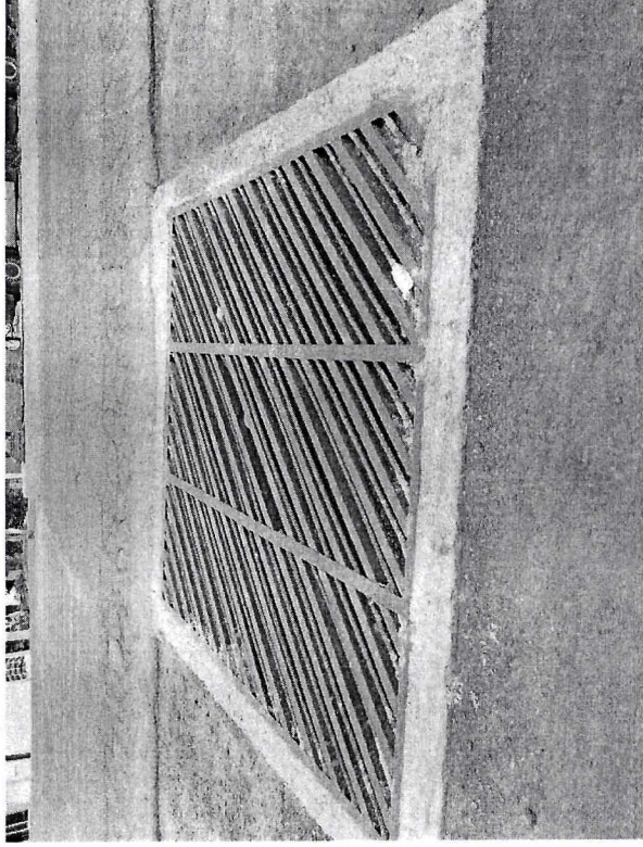
Obra: Construcción de drenaje pluvial en la Carretera Nacional en la cabecera municipal de Tizapán el Alto, Jalisco.
