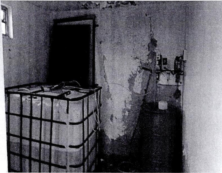
Vista general del pozo No. 13, suministro de insumo para desinfección de agua a base de hipoclorito de sodio al 13 %.
