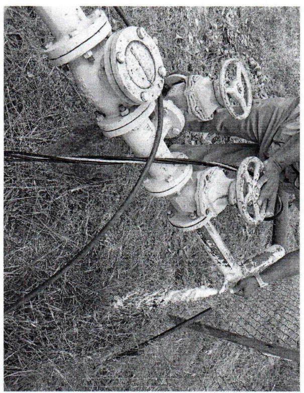
POZO DE AGUA EN LA ZONA INDUSTRIAL EN FUNCIONAMIENTO
