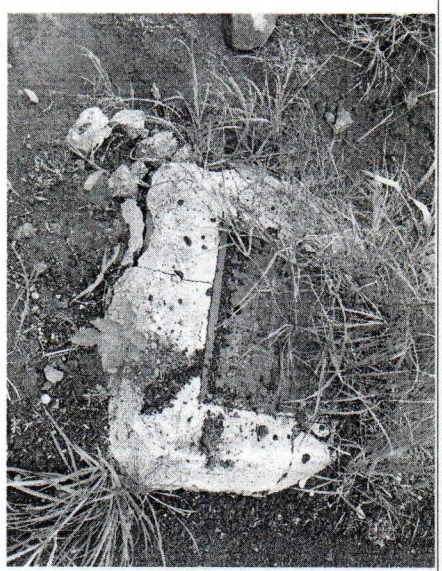
Registro de la válvula de admisión y expulsión de aire.
