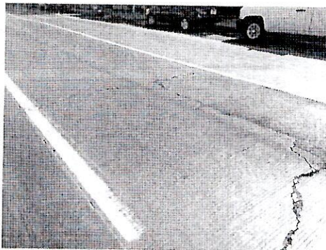
Losas de concreto hidráulico dañadas
